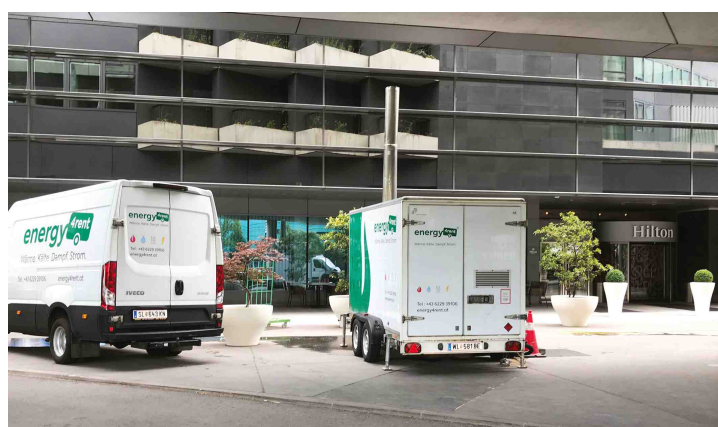
Die Fernwärmeabschaltung im Hilton Wien konnte perfekt überbrückt werden.
