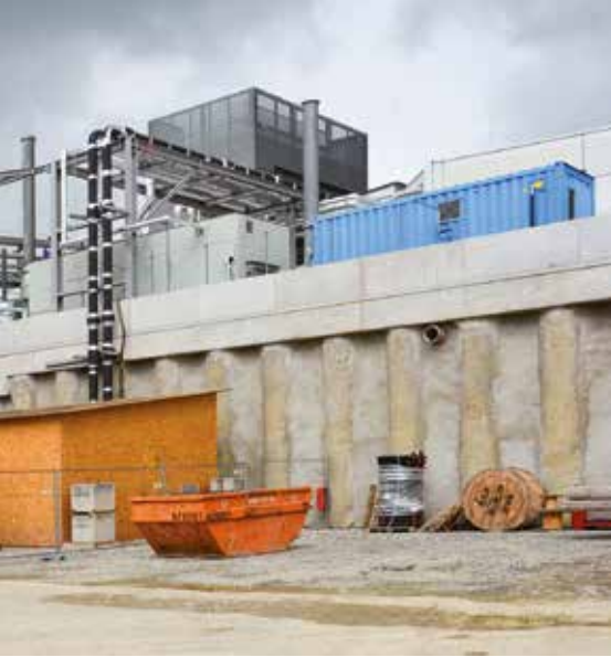
Bei Boehringer Ingelheim in Wien lieferte der Energie-Allrounder Mietlösungen für Wärme, Kälte, Dampf und Strom.
