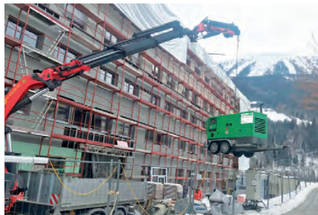
Mobile Stromproduktion für ein Objekt in Schwarzach/St. Veit
