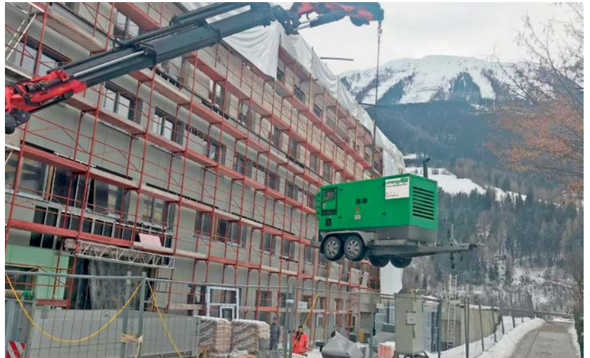
MOBILE ENERGIE Das Not-Stromaggregat energyMobil mit 110 kVA wurde auf eine Salzburger Baustelle geliefert, um nach einem Kälteeinbruch die Warmluftheizer mit ausreichend Strom zu versorgen.
